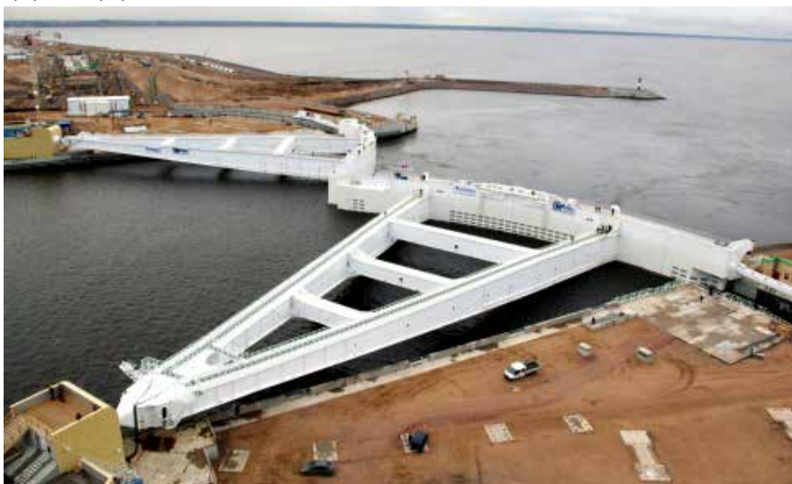
«Рубин» спроектировал сложные в инженерном отношении сегментные батопорты плывучего затвора судопропускного сооружения С-1
